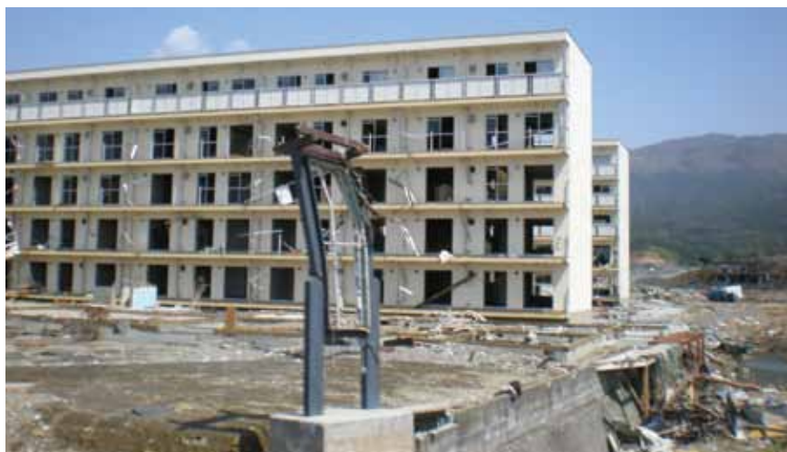
4階部分まで完全に破壊された町営住宅
