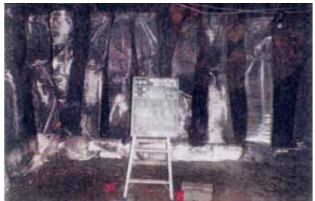
側壁から湧水が。埋め戻しにどう処理したのか？
